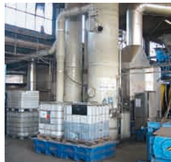
Installation d'extraction d'ammoniac pour la fabrication de solution de sulfate d'ammonium (Brinamon). L'ammonium issu d'un processus de fabrication est transféré dans un flux d'air sous forme d'ammoniac, ensuite lavé dans un second temps, puis fixé par un acide.
